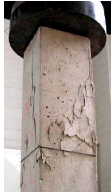
Figura 6.19 – Prisma após a ruptura.
