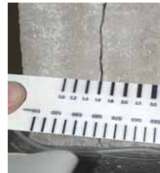
Figura 6.33 – Abertura da fissura.
